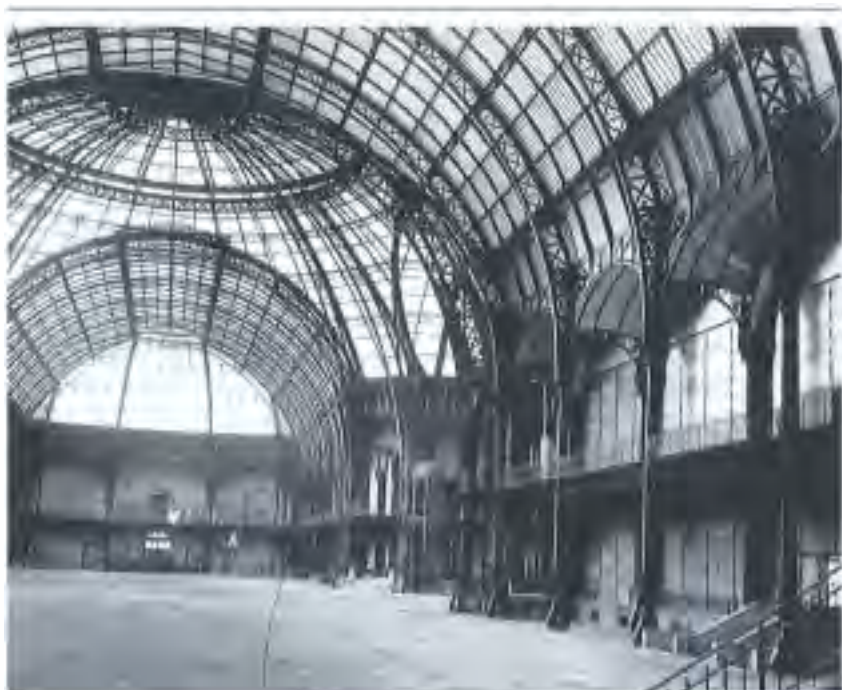
O Grand Palais não escapou à regra da época: depois da Torre Eiffel, a arquitectura do ferro impôs-se. Na foto, as estruturas do tecto do Grand Palais.
